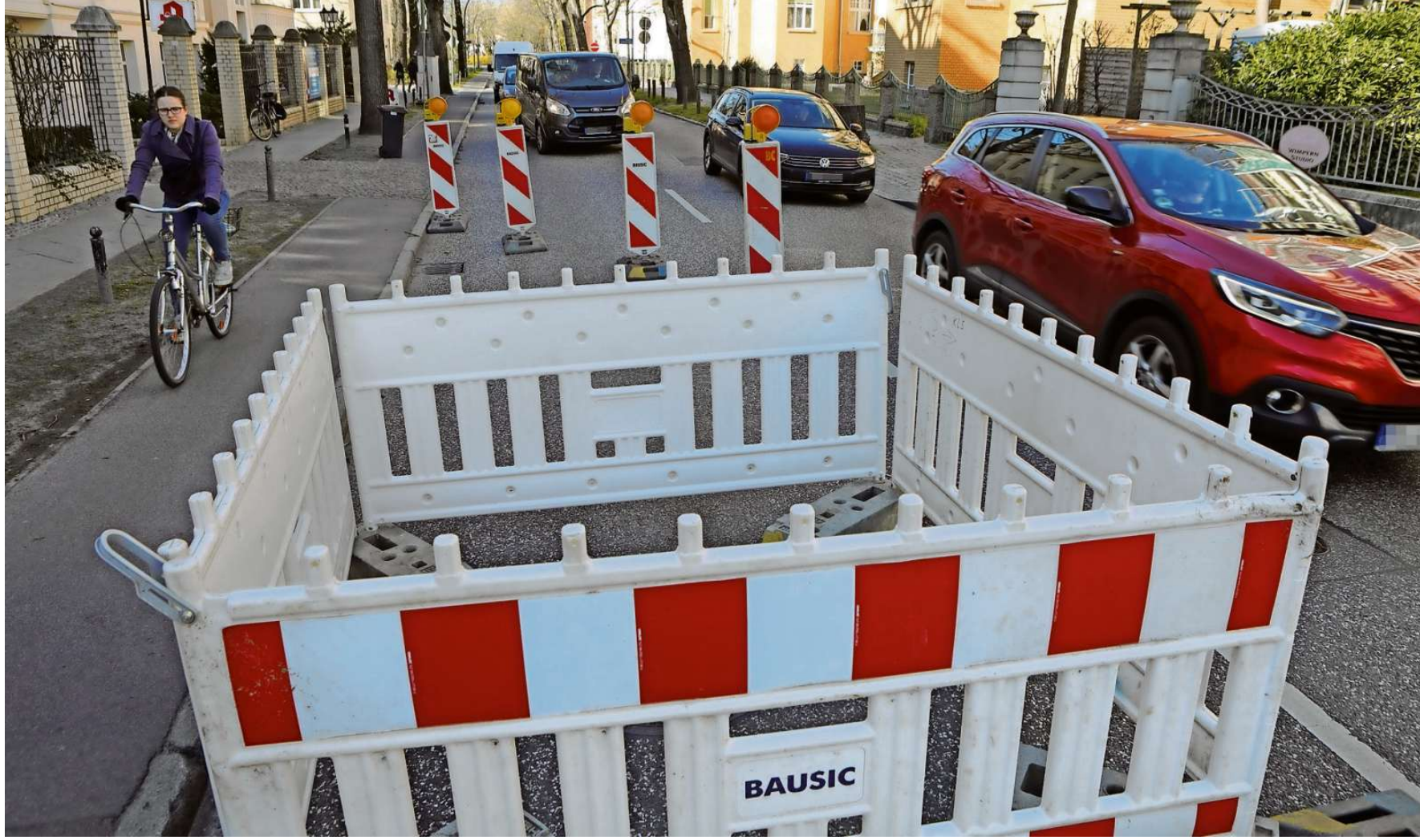
Hauptstraße wird dicht gemacht. Wegen eines Rohrbruchs an einem Abwasserkanal muss die viel befahrene Hans-Thoma-Straße zwischen Leibl- und Gutenbergstraße ab dem morgigen Mittwoch voll gesperrt werden. Die Bauzeit beträgt voraussichtlich eine Woche, teilte die Stadtverwaltung am Montag mit. In der Zeit bestehe Staugefahr im gesamten nördlichen Stadtgebiet – auch außerhalb des Berufsverkehrs. „Es wird empfohlen, das Gebiet weiträumig zu umfahren“, sagte eine Stadtsprecherin. Foto: Andreas Klauer
